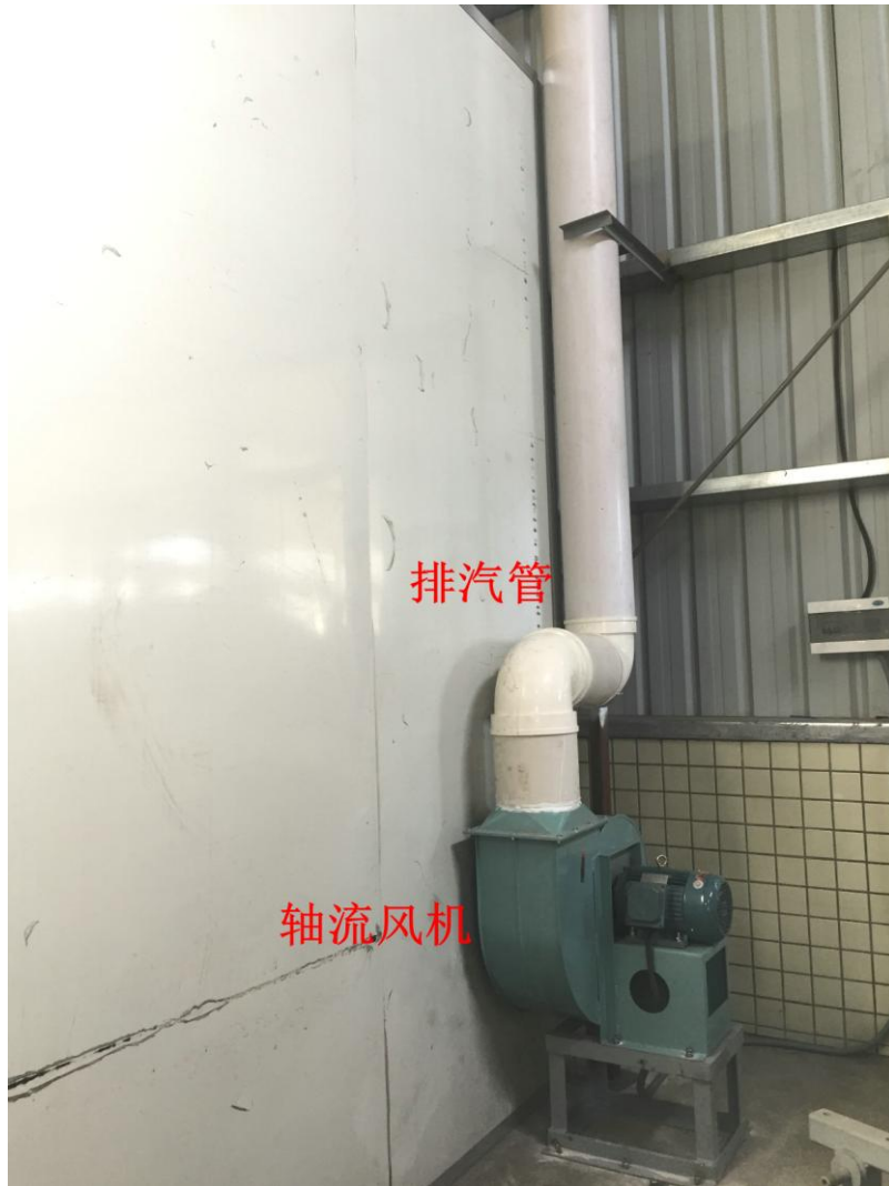
烤漆房废气排放口
