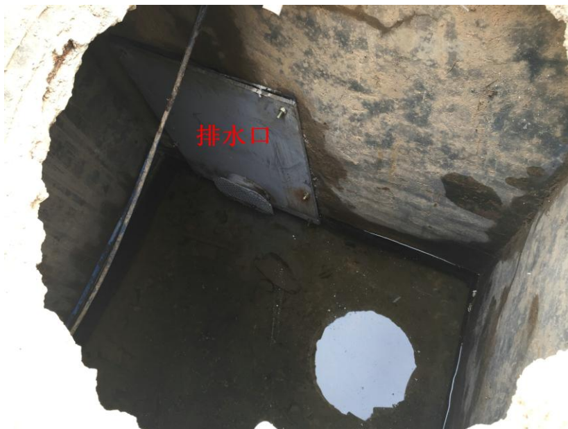
调试废水、生活污水和焊接废气处理废水汇集池
